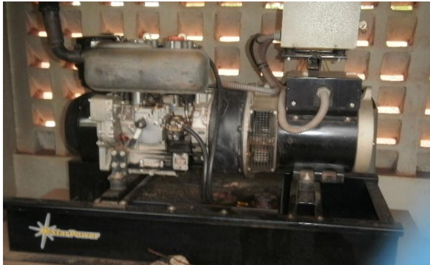
Photos 2: Groupe électrogène à Tintilou
